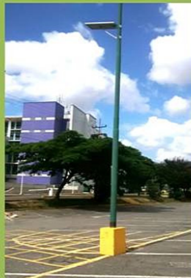
Luminaria Foto Voltaica Estacionamiento detrás de Biblioteca
